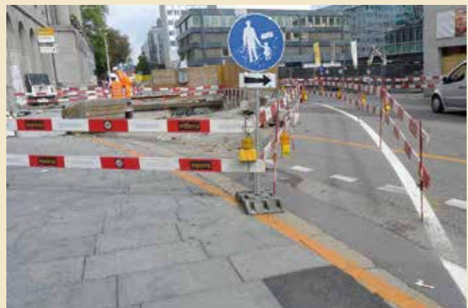
Le contraste des délimitations rouges et blanches joue un rôle important pour le guidage des piétons passant à côté d'un chantier.
