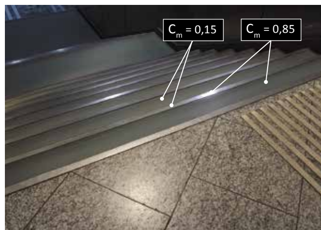
Les mesures de contraste effectuées sur cet escalier montrent à la fois des contrastes très élevés et très faibles. Les profils plats ne sont pas adaptés pour marquer les nez de marche.
