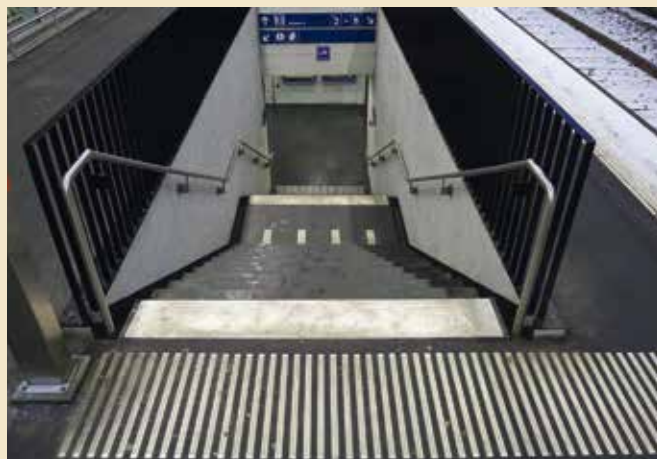
La première marche de la seconde volée est immédiatement repérable grâce à son marquage en plein. La fin de la première et de la deuxième volée l'est aussi grâce aux bandes perpendiculaires.
