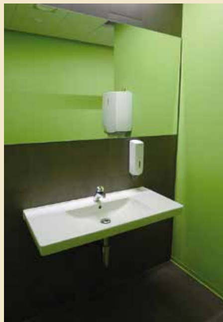
Les lavabos, les robinets et les distributeurs de savon faciles à trouver permettent une utilisation plus hygiénique de locaux sanitaires.
