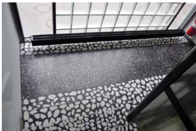
La composition très contrastée du revêtement rend la reconnaissance de chaque marche difficile. De plus, le même revêtement est utilisé comme frise sur le palier simulant ainsi une fausse marche.
