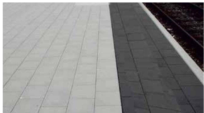
La limite entre les pavés clairs et foncés n'est pas perçue comme ligne de sécurité. La zone foncée peut, de plus, être confondue avec la fosse entre les voies.
