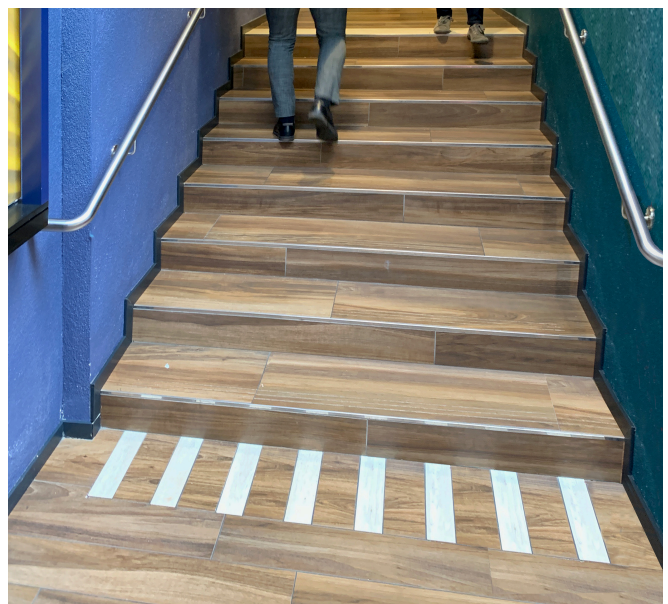
Exemple d'une solution constructive et durable concernant le marquage d'escaliers; Migros City, Zurich
