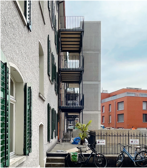
Unweit des Bahnhofs Winterthur wird ein Wohnhaus umgebaut. Mit dem Liftanbau, der als Solitär von der Fassade abgerückt steht, werden alle Geschosse hindernisfrei zugänglich.
